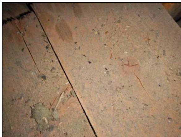
Abb. 9: Spuren von Fledermauskot auf dem Dachboden der Aldi-Marktfiliale
