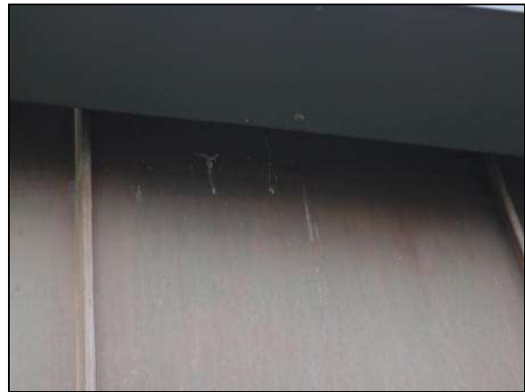
Abb. 4: Erste Anzeichen von tierischer Besiedlung fanden sich im Bereich der Dachüberstände
